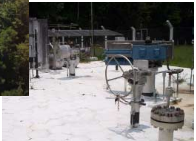
Área de válvulas para supervisão do gasoduto.
